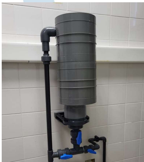
Point de surveillance eaux traitées
