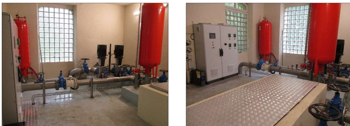
Figure 2 : Station de captage de la Chancelée
